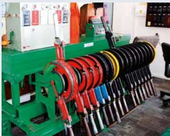
Weichenstellanlage im Stellwerk Stw1.
