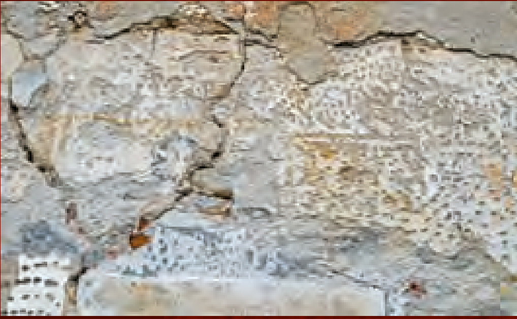
Pihlov (ČK), č. ev. 44, fragmenty náročné sgrafitové výzdoby na průčelí
