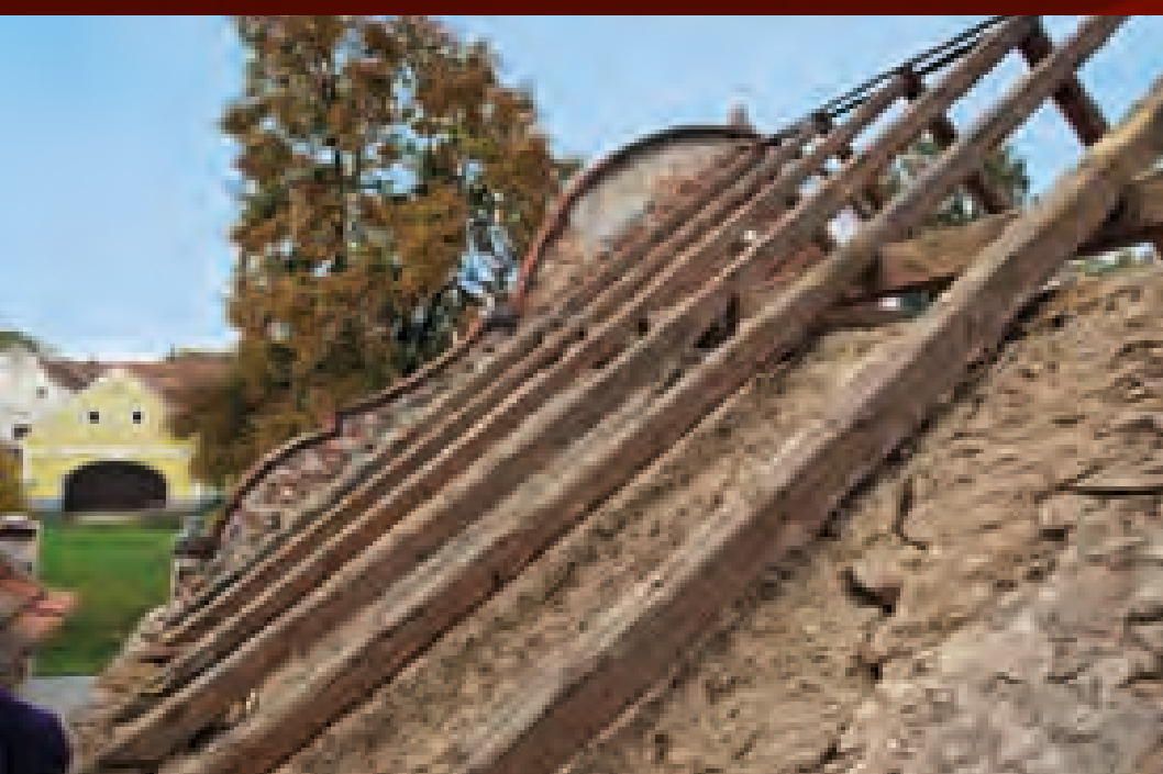
Holašovice (ČB), čp. 3, pohled na odkrytou unikátní konstrukci lepence nad obytným stavením
