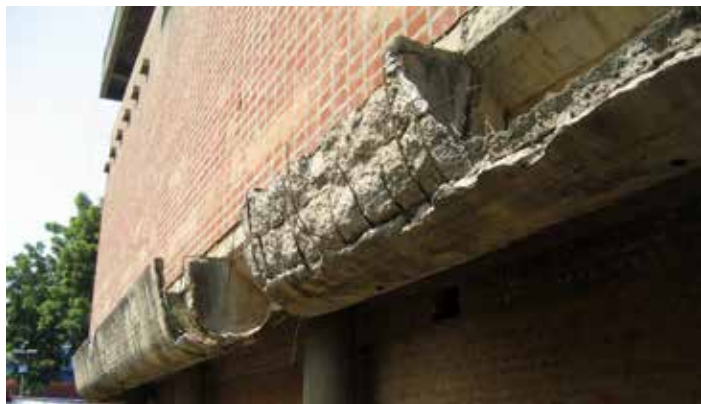
obr. 4: Poškozená železobetonová konstrukce budovy muzea Sanskar Kendra v Ahmedábádu. Foto: Hana Urbášková
